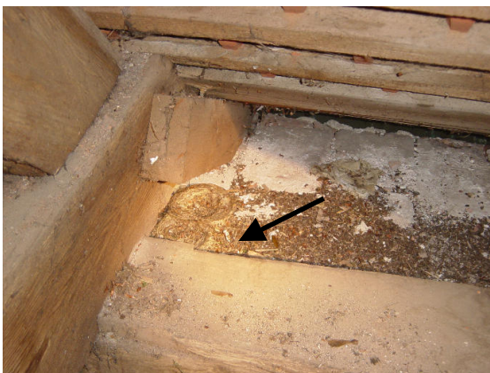
Mauersegler-Napfnester im einseharen Dachansatz
