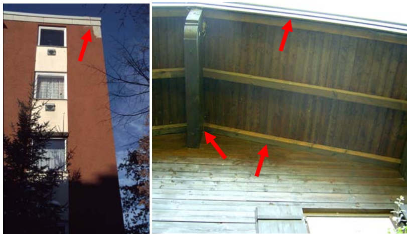
Abb. 17: Fledermausquartier hinter der Eternitverkleidung (links) und im Spalt hinter dem Holzbalken sowie hinter dem Windbrett (rechts). Pfeile: Einschluß.
