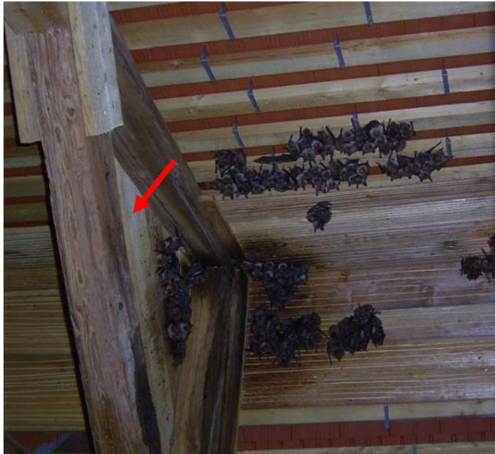
Abb. 23: Verbrettung des Firstbereichs in einer Mausohrwochenstube zum Erhalt des Warmluftstaus. Durch seitliche Bretter (Pfeil) wird ein Abzug der Luft in Bereiche mit Firstentlüftung verhindert.
