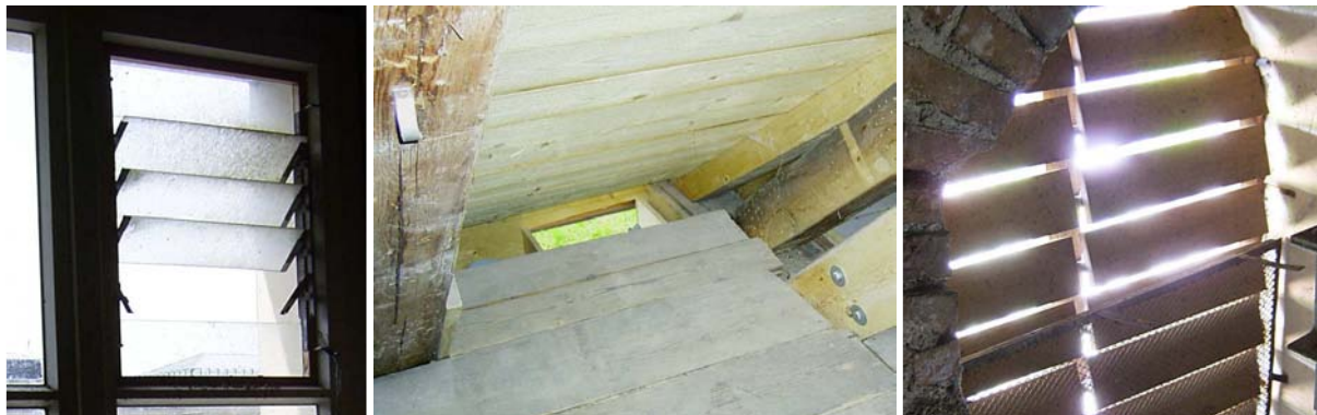
Abb. 2: Links: Lamellen in einem Glasfenster. Mitte: Sich nach unten hin öffnender Einflug im Dachüberstand. Rechts: Schalläden aus Holz mit einer Vergitterung im unteren Bereich.
